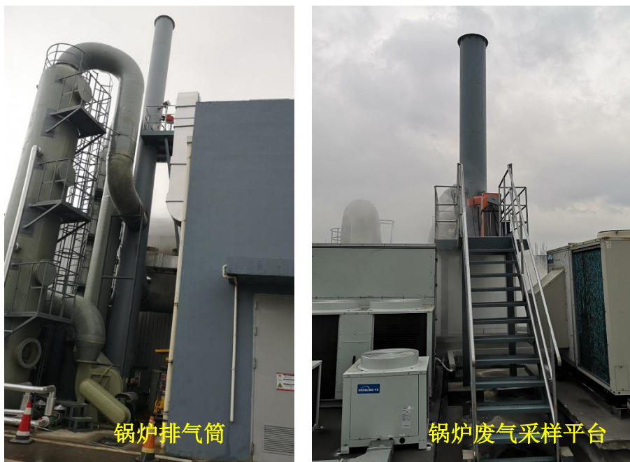
图 4-1 项目废气处理设施
